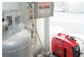
島ではLPガスが重要なエネルギーです
