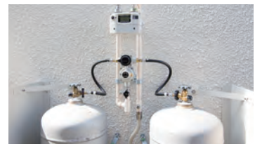
新たにLPガスを導入いただきました(写真右側)
