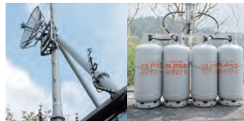
3つの基地局に設置されています
