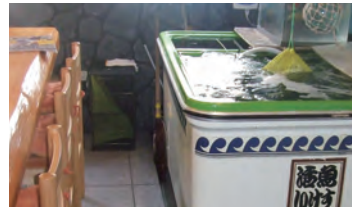
停電時は、鮮魚水槽にも使用
