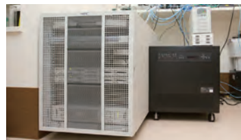
リチウムイオン蓄電池と医用UPSを組み合わせています(写真右側)
