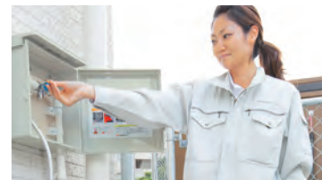
供給ボックスは2箇所に設置されています
